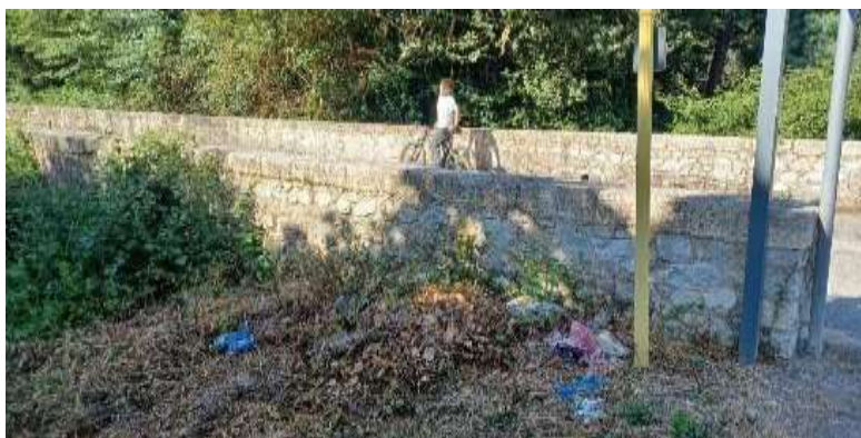
Fig.4 – Poluição na Ponte Pedrinha
